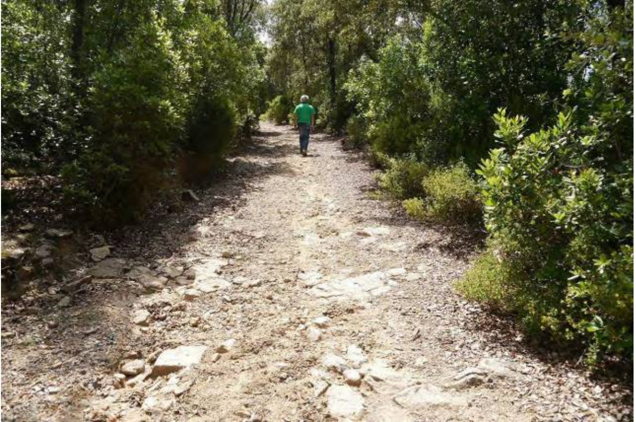
Foto 7. Tratto CD, evidente l'erosione superficiale ad opera delle acque meteoriche.
