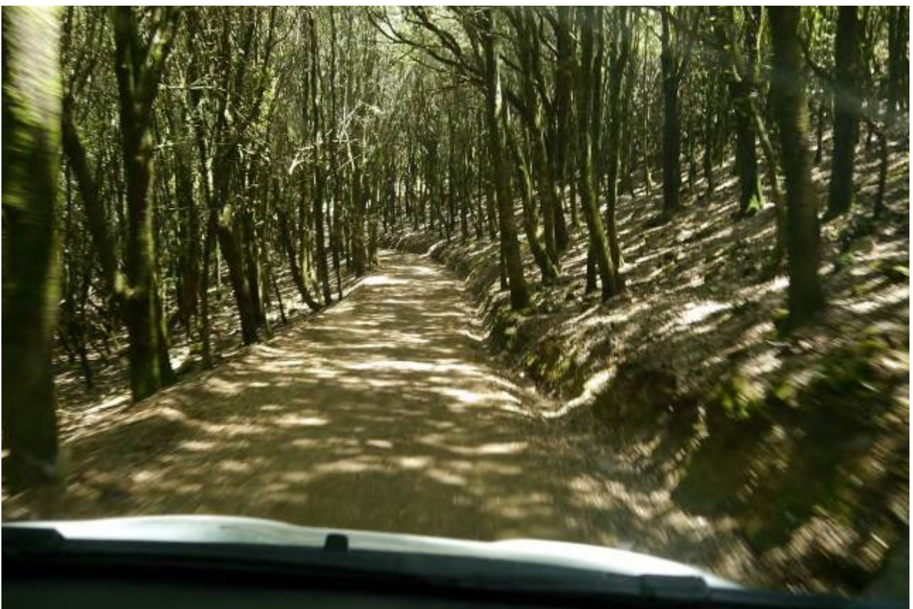
Foto 4. Tratto AB, parte del sentiero che si sviluppa su strada sterrata. In evidenza le cunette laterali invase da fogliame e materiale detritico.
