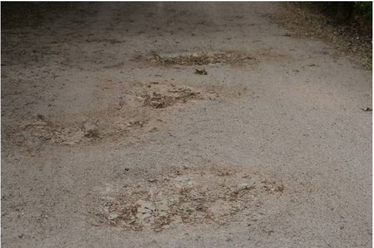
Foto 10. Tratto AB, particolare delle buche presenti in alcuni zone del sentiero.
