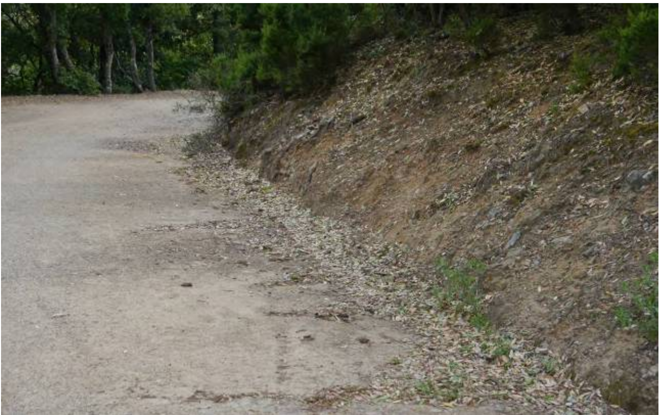
Foto 9. Tratto AB, particolare dei canali di scolo laterali, colmi di fogliame e di detriti.
