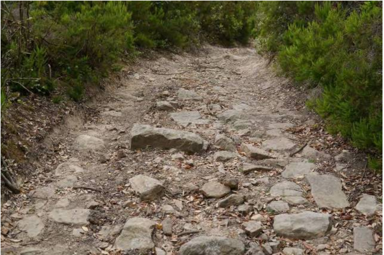
Foto 12. Tratto CD, particolare del dissesto che caratterizza la prima parte del sentiero, circa 200 metri.
